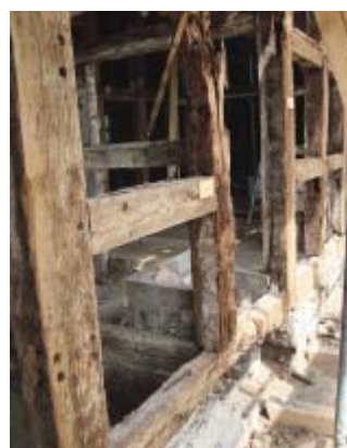
Ramponiert: Morsches Holz muss ersetzt werden.
