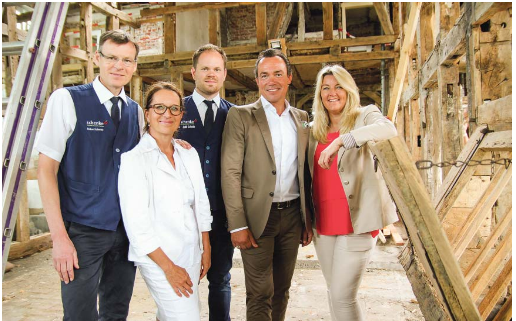
„Das hat sofort gepasst“: Reiner Schenke (v. l.), Jeannette Hölscher-Schenke, Janik Schenke, Thomas und Barbara Hagedorn gehen ihr Gemeinschaftsprojekt bei Upmann an der B61 mit großer Zuversicht an. Das Fachwerkhaus von 1735 ist komplett entkernt. FOTOS: RAINER HOLZKAMP
